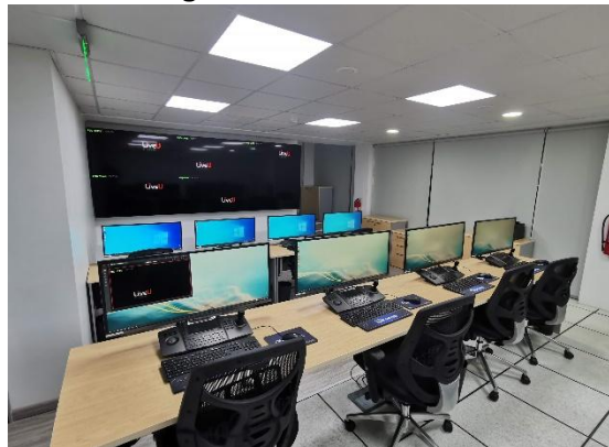
Figura 4: Sala de monitoreo
